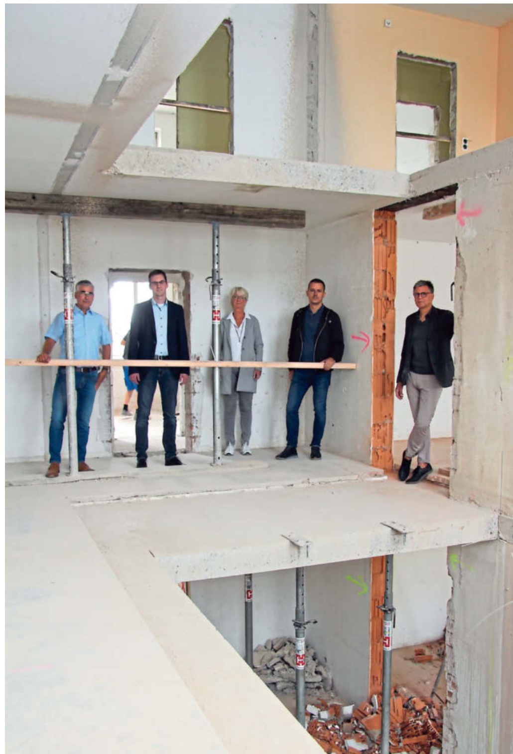
Thorsten Paulussen, Matthias Kalkreuter, Petra Lesemann, Lulzim Maliqi und Andreas Rimkeit (von links) stehen im Übergangwohnheim in der Bredestraße 1, das derzeit umgebaut wird. Im Loch vor ihnen entsteht das zusätzliche Treppenhaus als zweiter Fluchtweg.
