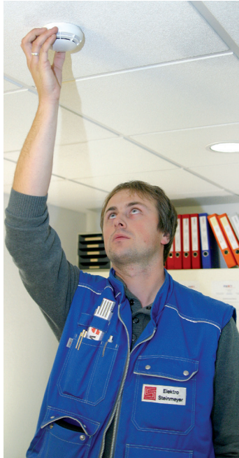
KONTROLLE: Mitarbeiter Dirk Seidel überprüft routinemäßig eine Brandmeldeanlage
